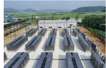
건물 내 발전용 연료전지
